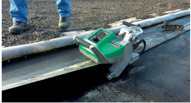
GEOSTAR без проблем сварил шов длиной около 240 метров за один проход во время полевых испытаний (Южная Африка)
