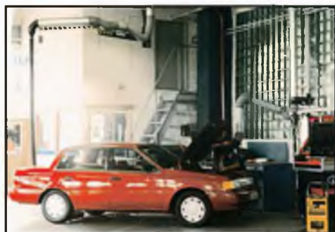
Санкт-Петербург. СТО "Форд". Вытяжное устройство VEGA на двухбалочной консоли с подключением к системе вытяжной вентиляции.
