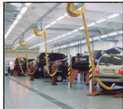
г. Санкт-Петербург. СТО "Аксель-Кар". Комплексное оснащение рабочих мест вытяжными катушками.
