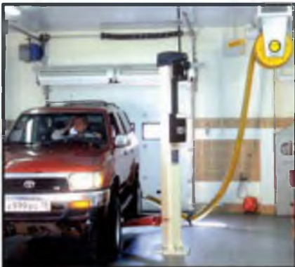
г. Санкт-Петербург. СТО "Аксель-Кар". Вытяжная катушка с гибким термостойким шлангом.
