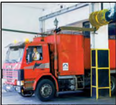
г. Санкт-Петербург. ГУП "Водоканал СПб" САБ-2. Вытяжная катушка, подключенная к центральной системе вытяжной вентиляции.
