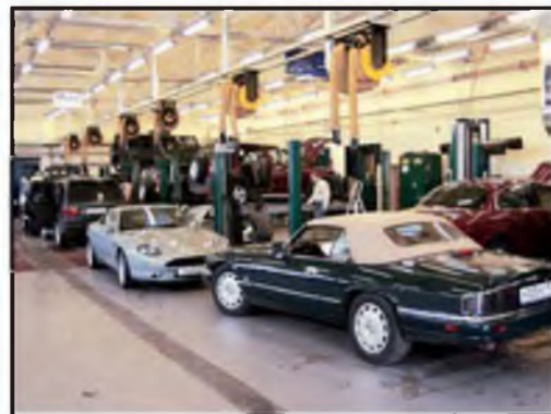
г. Москва. Технический центр "Муса-Моторс". Оснащение рабочих мест вытяжными катушками с Y-образным шлангом на две выхлопные трубы.
