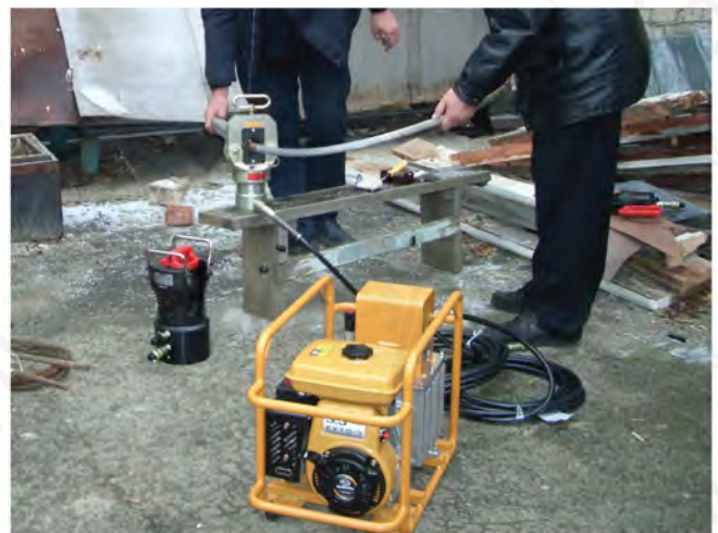
пресса EP-520C и EP-100W и насосная станция НРБ-4
