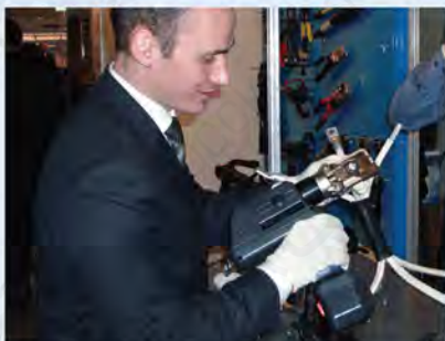
Опрессовка REC-651F кабеля АВВГ 4х95
